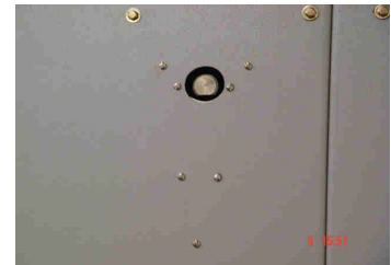
Accionamiento de flecha de cuchilla de operación sin carga preparado para el cierre
